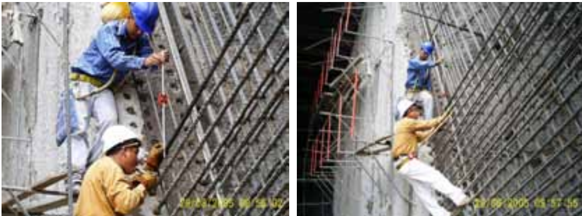
Fotografías 11 y 12. Armado de refuerzo de acero para el muro derecho del bocatoma 2.
