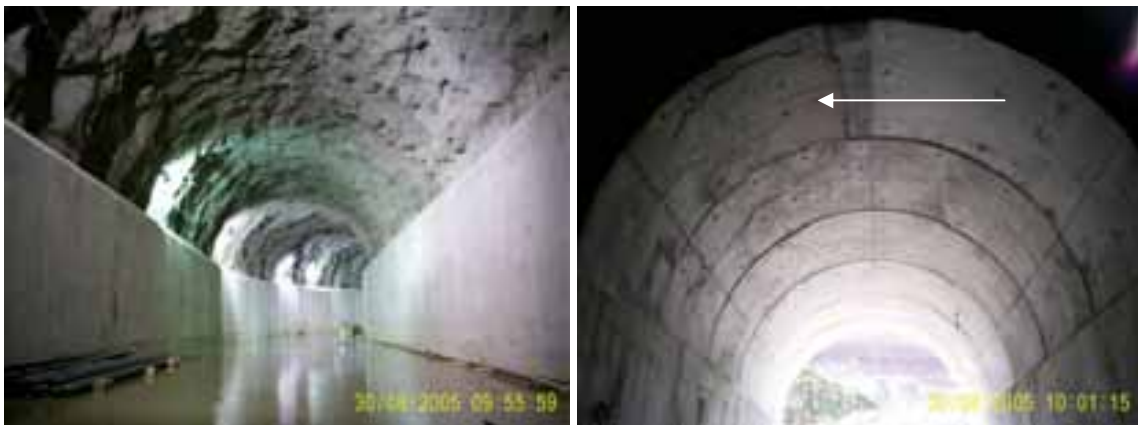
Fotografías 33 y 34. Revestimiento de concreto en muros y bóveda del túnel de desfogue.
