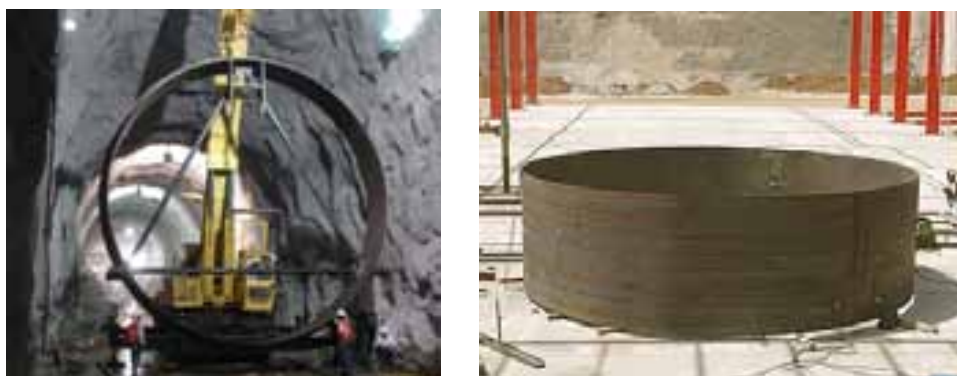
Fotografías 16 y 17. Canuto o placa de blindaje de acero. Vista general del primer canuto.
