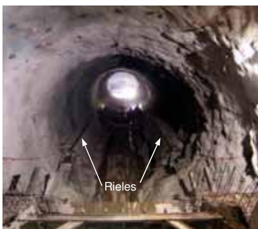
Fotografía 18. Colocación de rieles de acero en el ramal inclinado de la tubería a presión 1.
