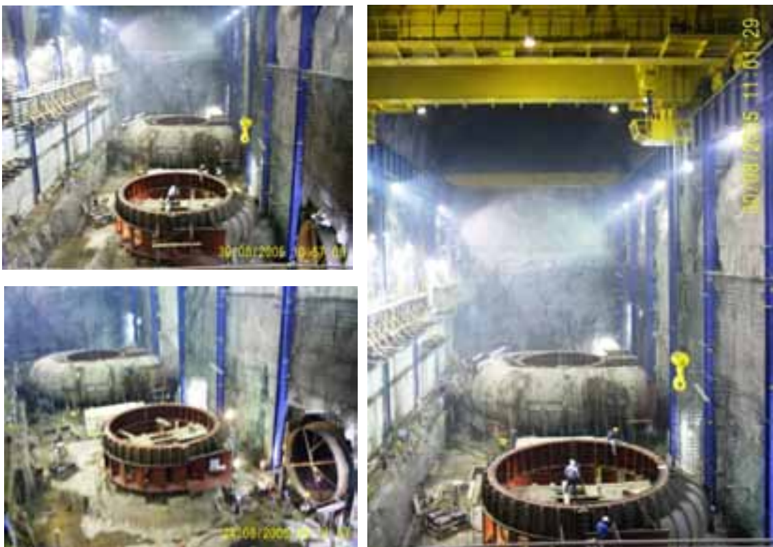
Fotografías 6 y 7. Vista general de la casa de máquinas. En las fotos se observan la carcasa en forma de caracol de la turbina no. 2 y el antedistribuidor de la turbina no. 1.
