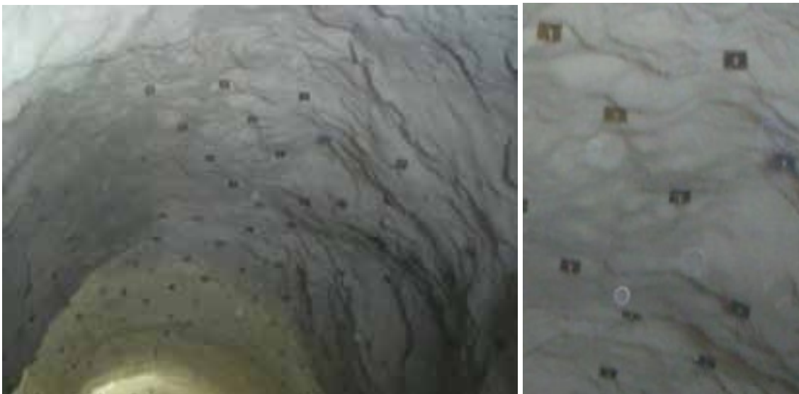
Fotografía 15. Anclas de fricción de varillas de acero en el codo inferior de la tubería a presión 2.
