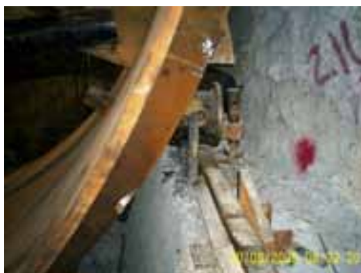
Fotografía 21. Soporte del canuto sobre el riel.
