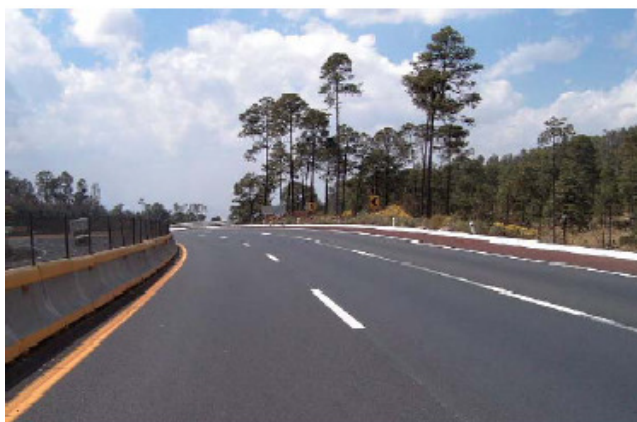
Fotografía 1. Curva horizontal izquierda, con distancia de visibilidad deficiente por no cumplir con la distancia libre de obstáculos mínima.
