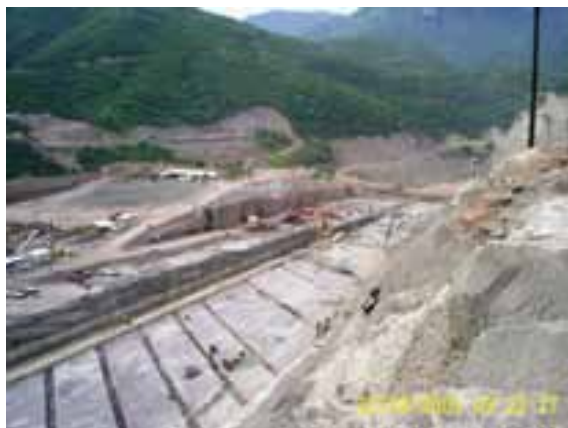
Fotografía 27. Drenes en losas del canal de descarga (margen derecha) del vertedor.
