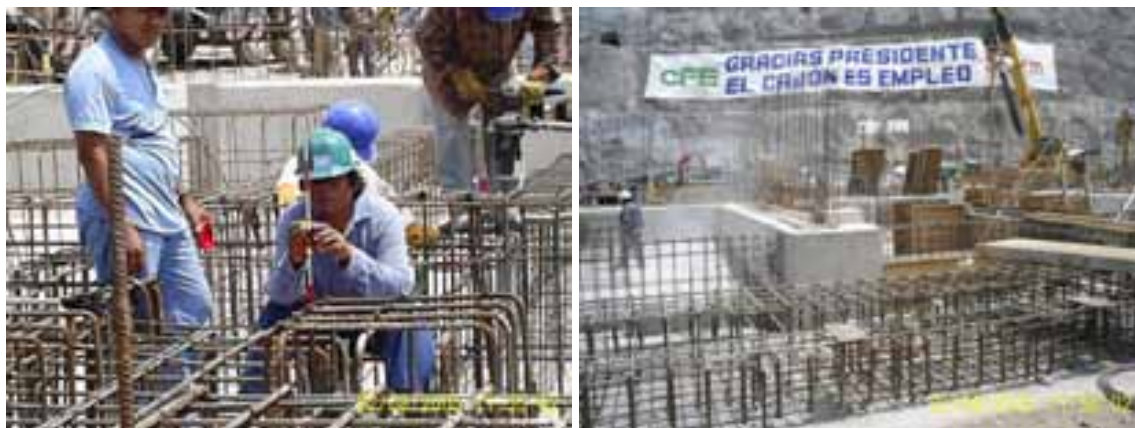
Fotografías 37 y 38. Cimentación en la zona de transformadores y edificio de control.
