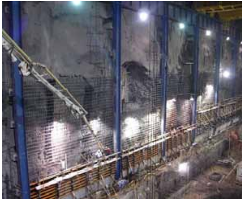
Fotografía 25. Colocación de refuerzo de acero y cimbra para el colado del muro aguas abajo en Casa de máquinas.
