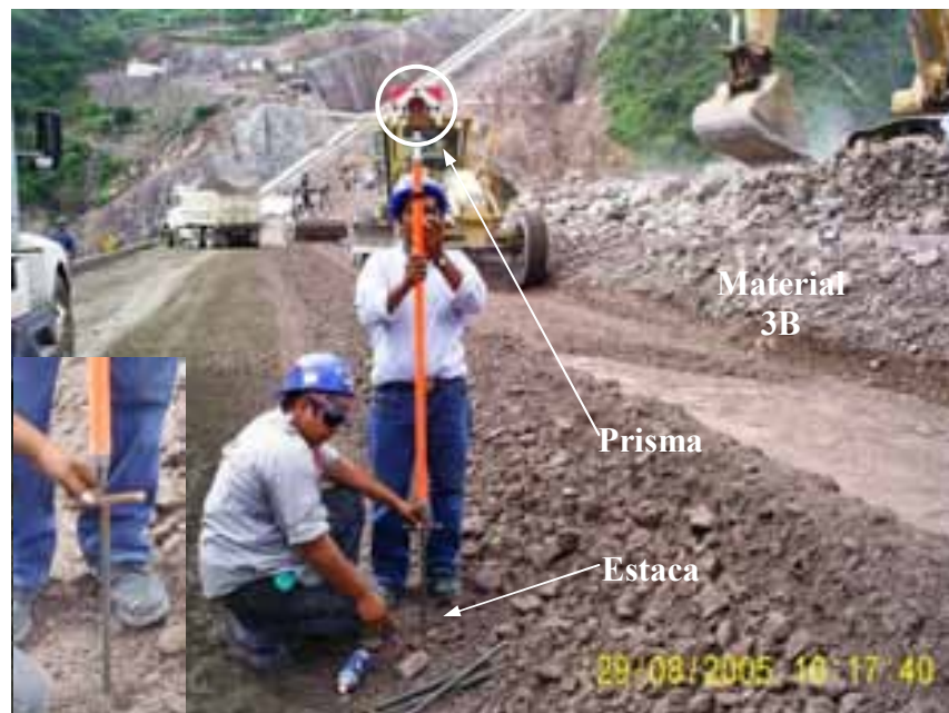
Fotografía 8. Colocación de estacas de nivel para marcar el espesor de la capa y límite de cada material.
