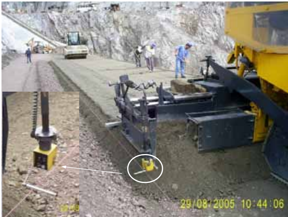
Fotografía 9. Sensor de nivel de la esparcidora sobre un hilo para el espesor y colocación de la capa de material 2.
