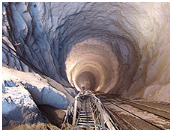
Fotografía 5. Rama inclinada en la tubería a presión no. 1
