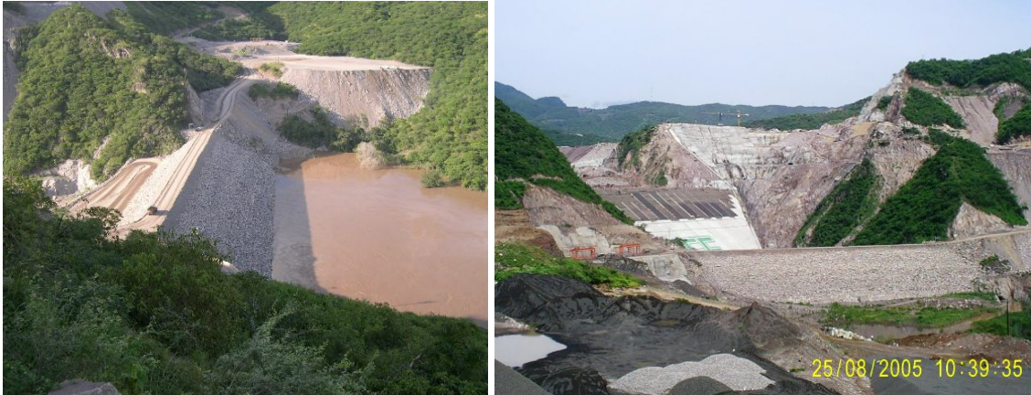
Fotografías 4 y 5. Ataguía aguas arriba. En la siguiente fotografía, se encuentra la misma ataguía y al fondo se observa la cortina de concreto.
