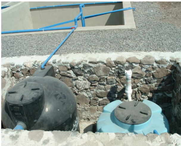
Tanques de filtración
