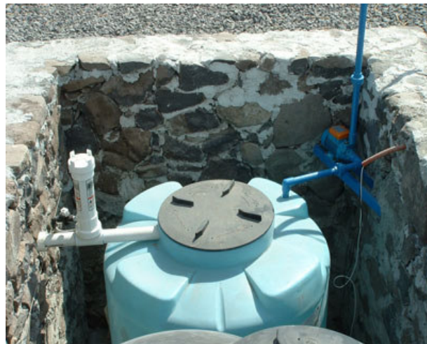
Tanque de cloración
