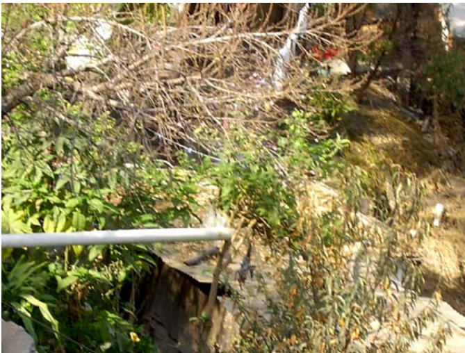
Tubería para descargas de aguas en el cauce del río
