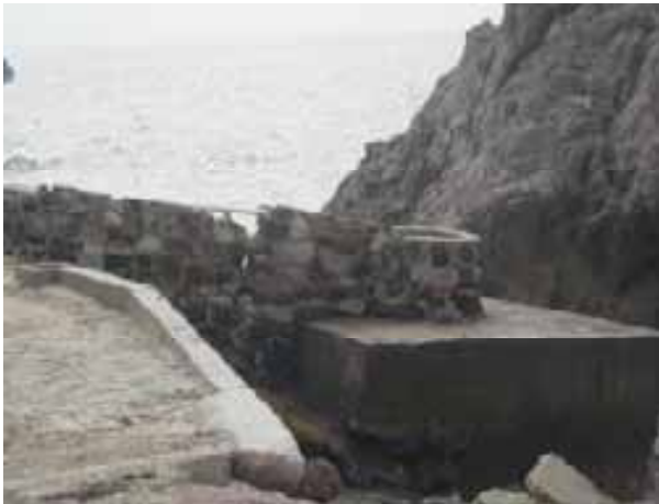
Foto 3.- Cárcamo de bombeo de agua marina
