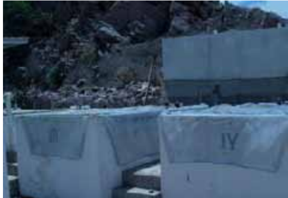
Foto 27.- Estanques tapados y en etapa de operación.
