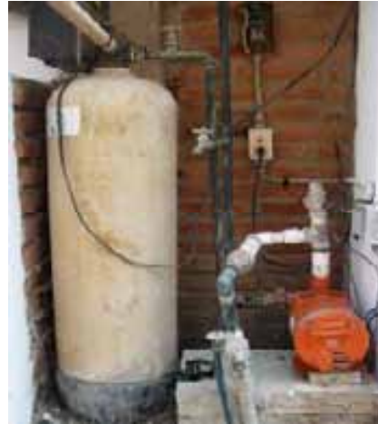
Figura 2.- Filtro y sistema de bombeo para el agua dulce.
