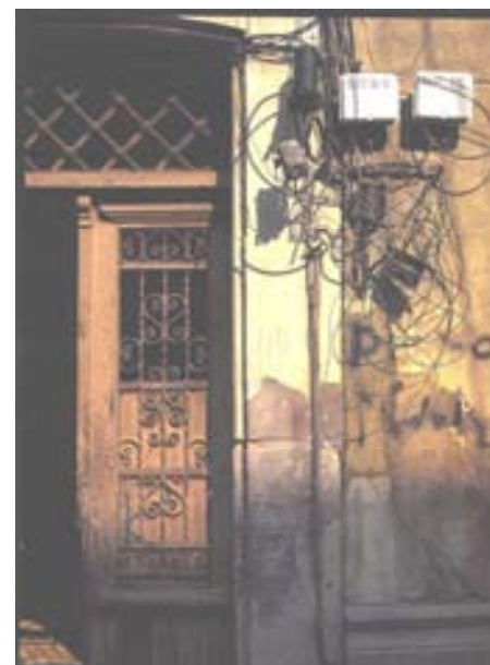
Deterioro de fachadas
