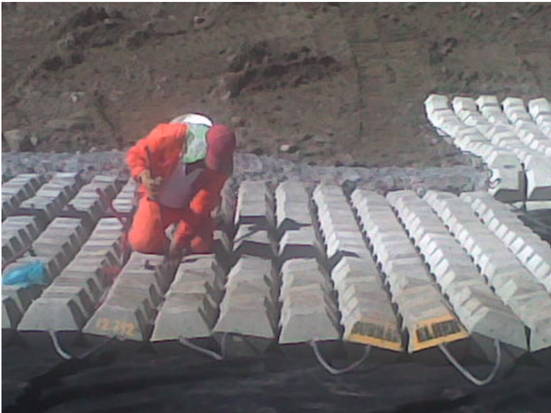
Fig. 2.9 La mano de obra local sólo fue empleada en labores secundarias de albañilería y limpieza de las obras.
