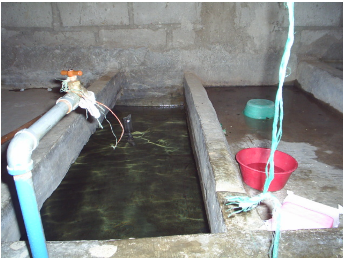
Fig. 3.5 Algunos habitantes del fraccionamiento han acondicionado tanques de cemento o cisternas dentro de sus casas, para almacenar agua debido a que el suministro puede espaciarse hasta por 15 días en la estación seca.
