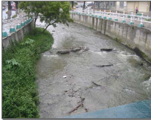
Presencia de escombros en los ríos y desgaste de los muros. Fuente: Archivo del Autor. Fecha: Julio/2007
