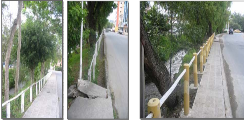
Veredas en el río Zamora en donde se nota el deterioro y la escasa dimensiones en las mismas Fuente: El autor (nov. 2008). inapropiadas para el tránsito peatonal. Fuentes: Archivo del Autor. Fecha: Diciembre /2007
