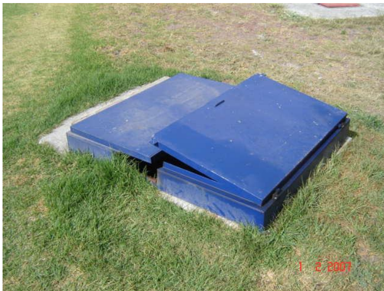
Toma y conexiones de sistema de riego
