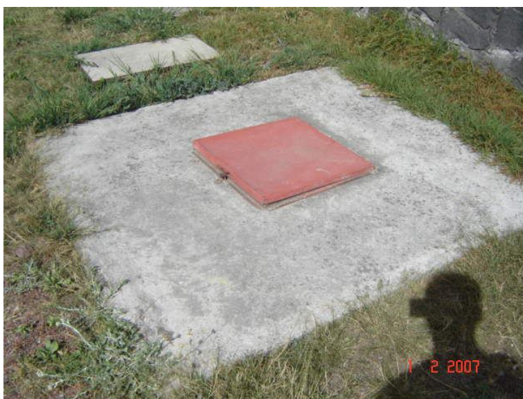
Registros de sistema de drenaje
