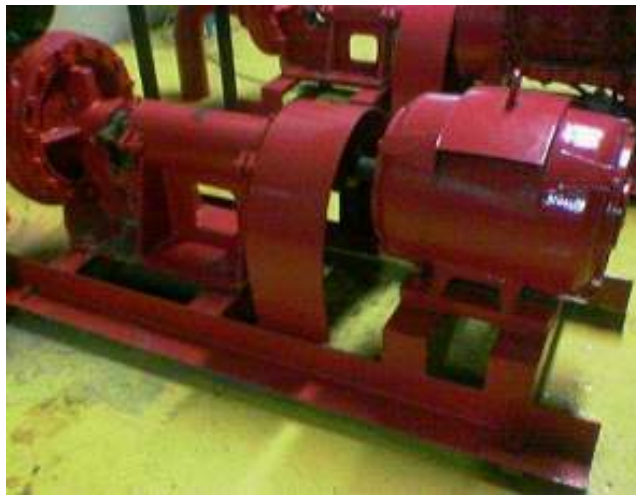
Ilustración 45 Bomba contra incendios 40HP
