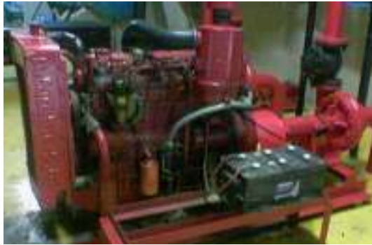
Ilustración 46 Bomba contra incendios Perkins
