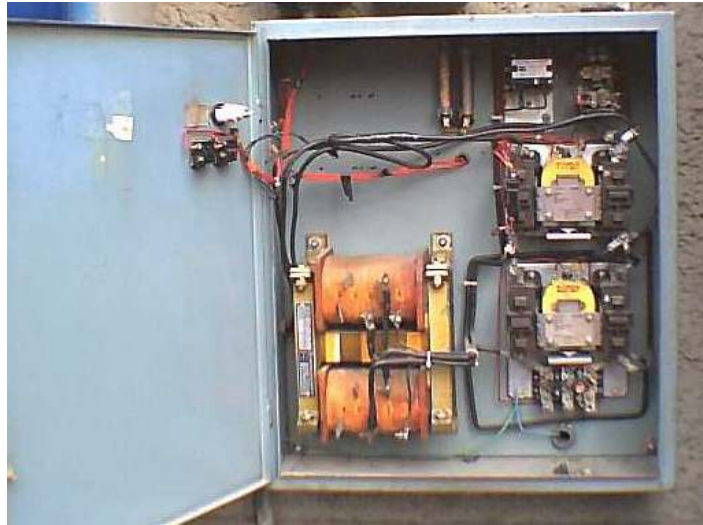
Ilustración 35 Tablero de arranque
