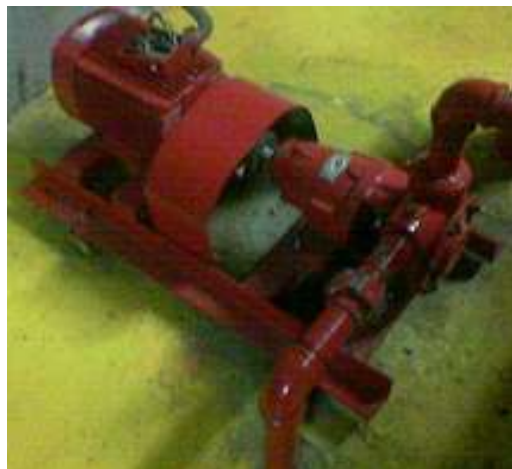
Ilustración 44 Bomba contra incendios 3HP
