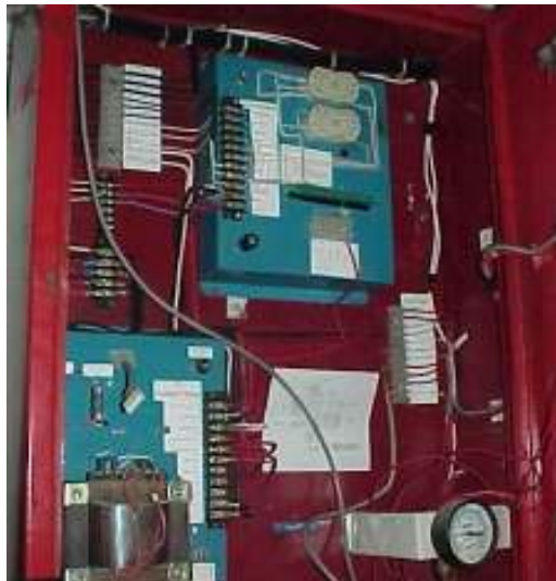
Ilustración 47 Tablero de control bomba Perkins
