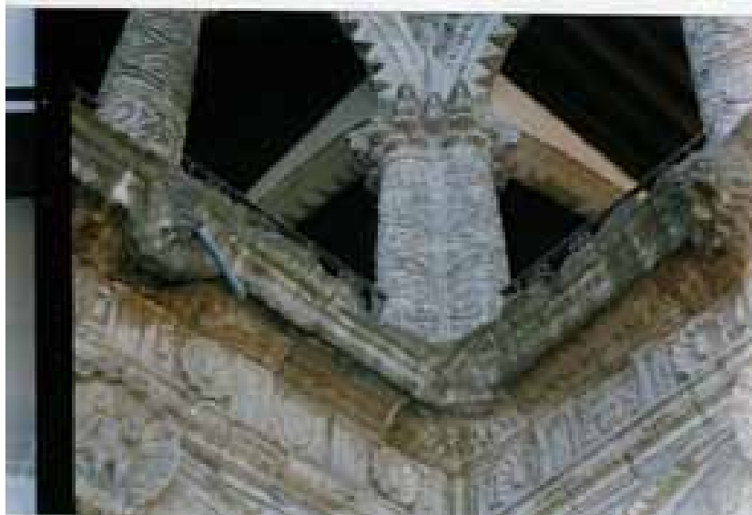
Desgaste y pérdida de material en la cornisa de entrepiso, así como la presencia de pátina.
