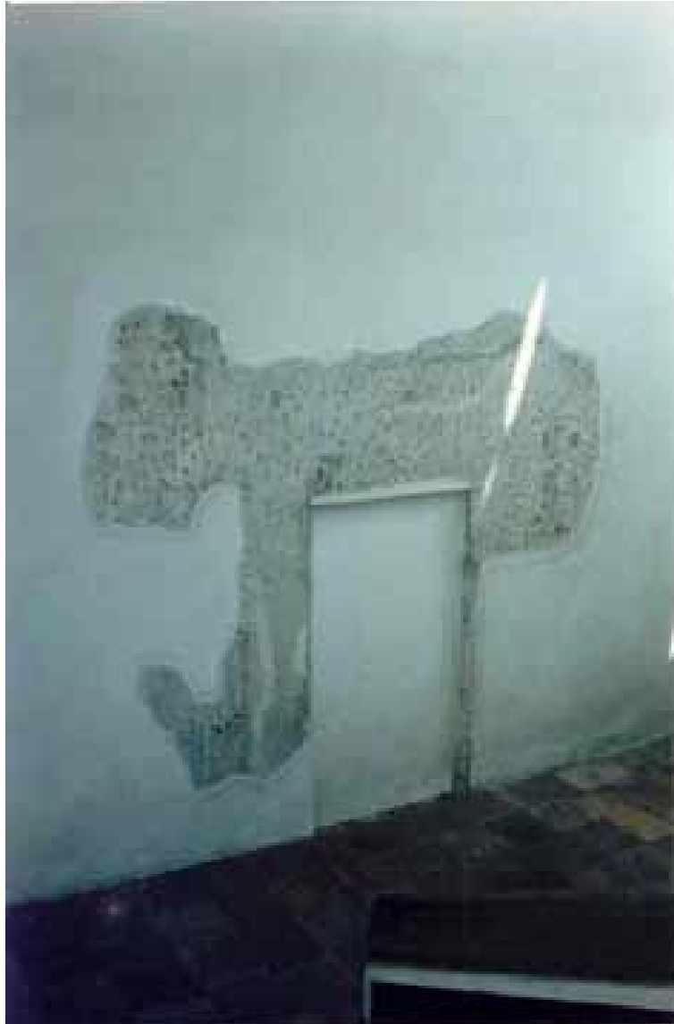
Descanso de la escalera. Aquí realizaron calas encontrando restos de pintura mural, aunque es poco visible.
