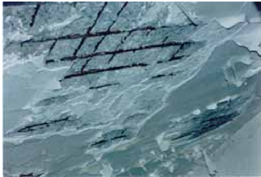
Desgaste por la humedad así como desprendimiento de material en el agregado realizado.
