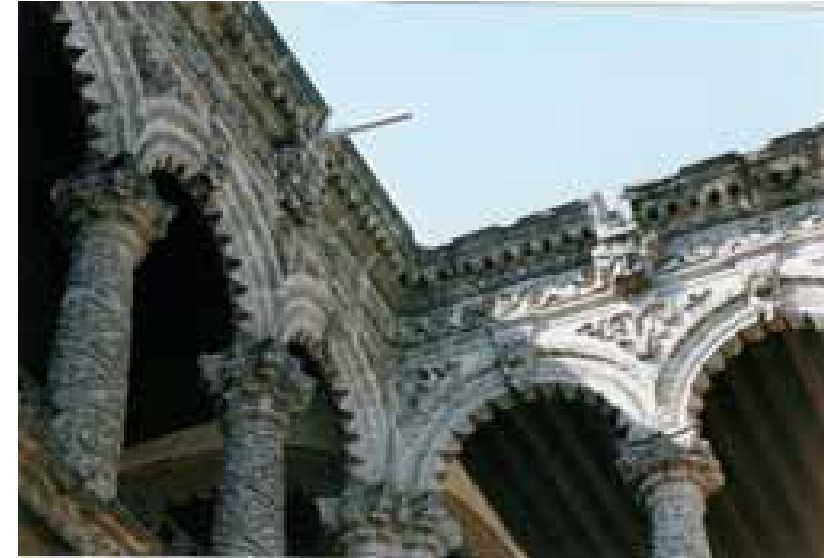
En esta foto vemos el faltante de dos gárgolas que se han desprendido.
