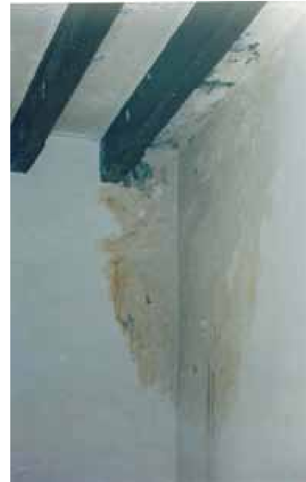
Presencia de humedad en la planta alta, lo que ocasiona salitre y manchas, además de dañar el material.
