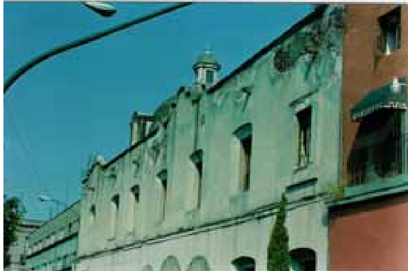
En la fachada principal también se presentan daños por la humedad y la lluvia, por lo que vemos un desgaste en el material.
