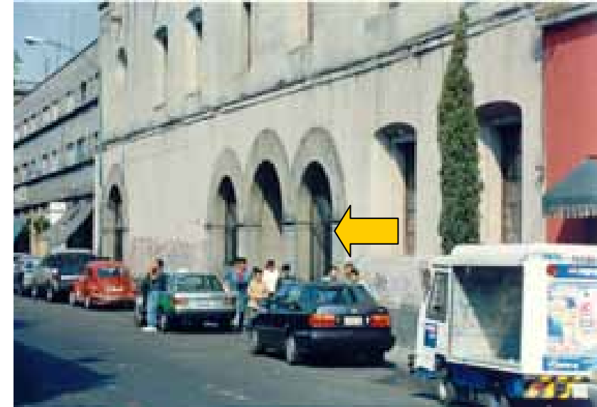
Los arcos que se ven, fueron realizados en 1930 para el acceso al claustro. Como puede verse, hay algunos daños por pintas en la fachada, así como costra negra y desgaste de la misma.
