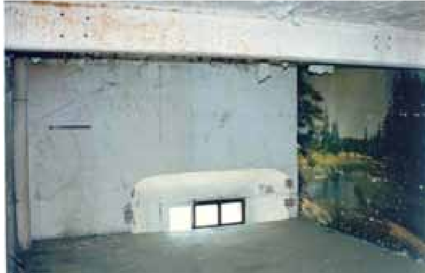
Piso agregado en la zona de tapanco hecho en la zona de la escalera que sube a la azotea y que visualmente corta el ventanal. También podemos apreciar desprendimiento del material y un tapiz que fue puesto en el muro.
