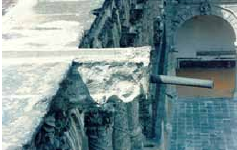
Desgaste de una gárgola en la azotea por erosión y pulverulencia.
