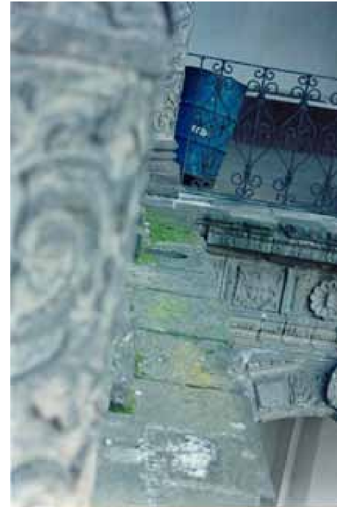
Crecimiento de musgos y líquenes en el primer nivel del claustro.
