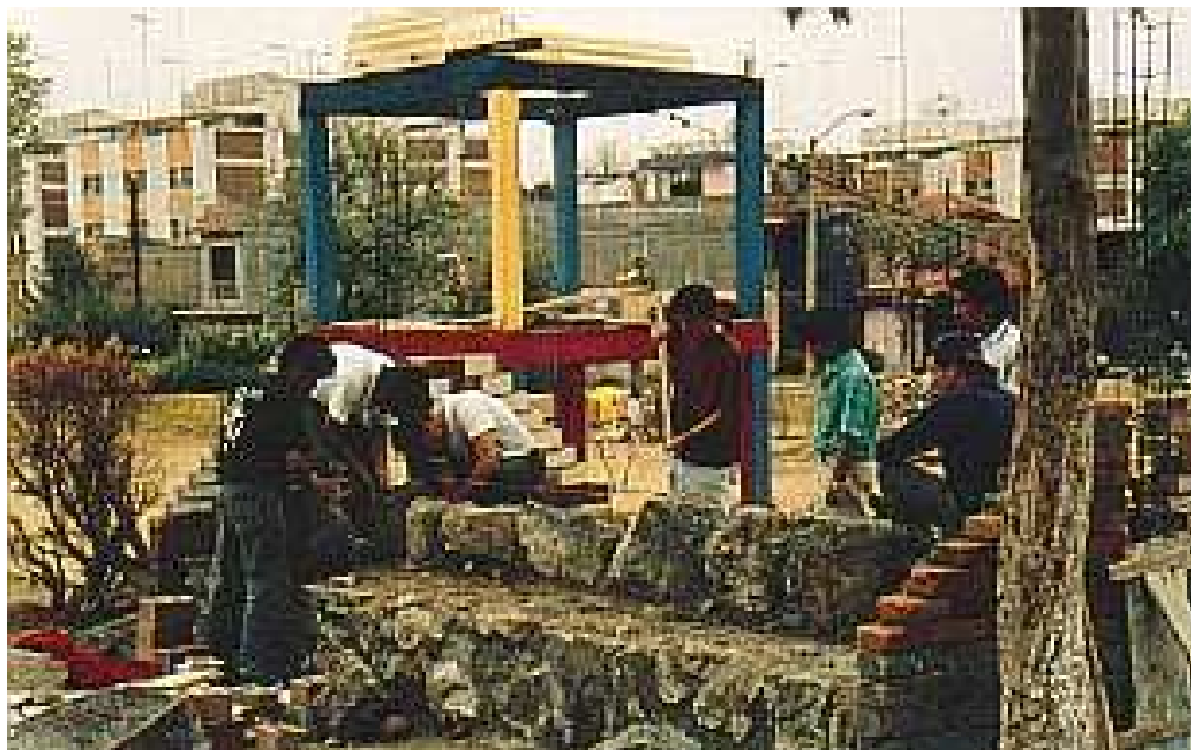
738.- Alumnos de la Facultad de Arquitectura de la U.M.S.N.H. construyendo las gradas de la cancha de fútbol. Atrás, la torre de deslizamiento.
