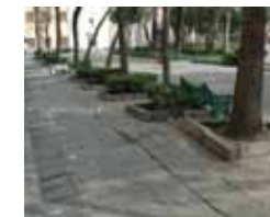
Deterioro en el pavimento
