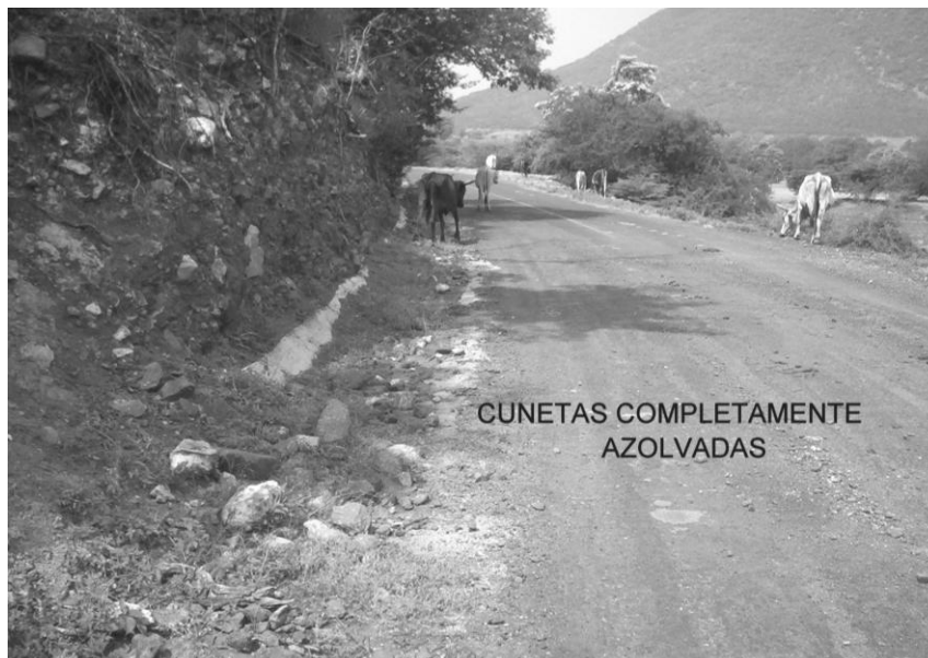
FOTO 02: Cunetas completamente azolvadas.
