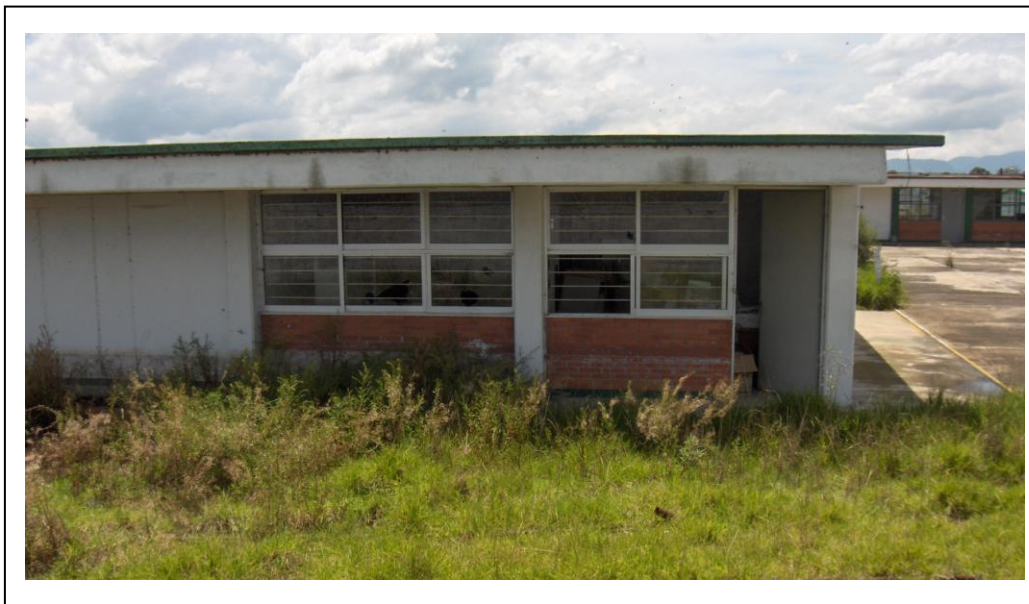
Figura 3.12 Escuela preparatoria No. 51: abandonada permanentemente
