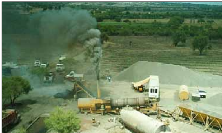
Foto 4.- Planta estacionaria de asfalto.
