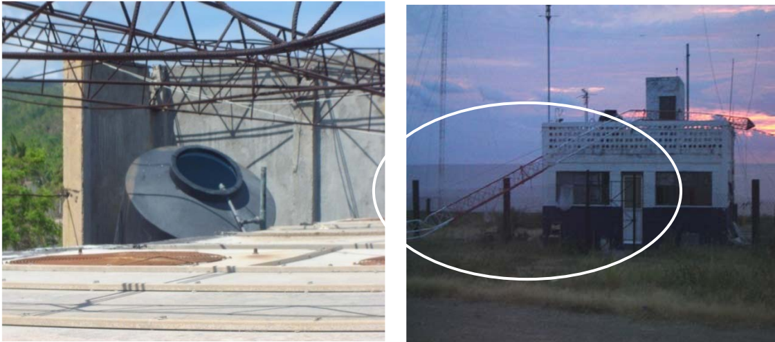
Figura 2.12 Tinacos y antenas desprendidos
