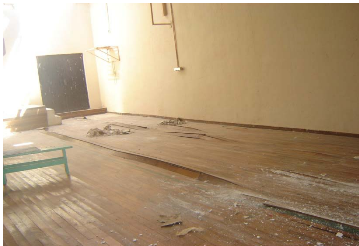
Figura 2.17 Deterioro de la duela de madera del coliseo
