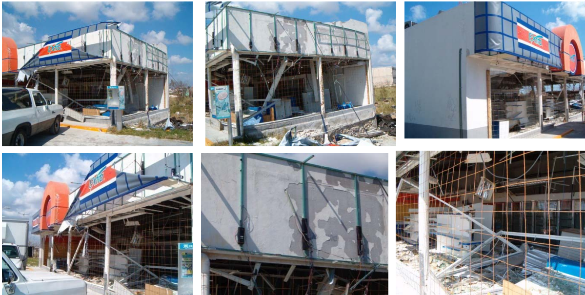
Figura 2.30 Daños en minisuper de la gasolinera 10G
