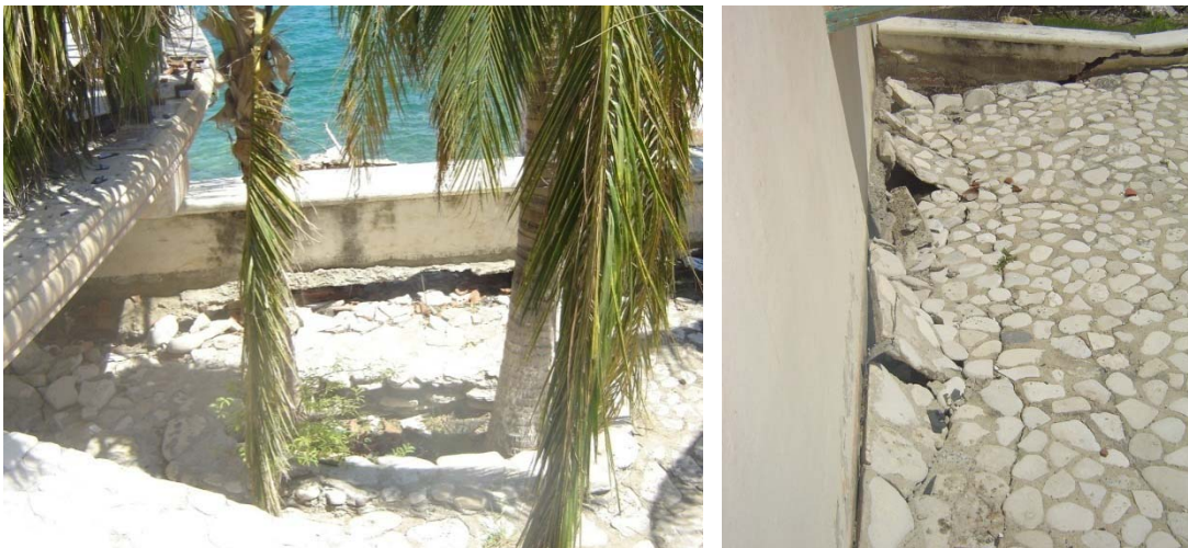
Figura 2.19 Asentamiento alrededor de la biblioteca y la sala de audiovisuales (zona aledaña al rompeolas)
