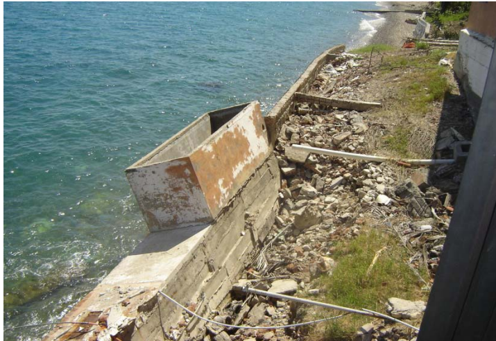
Figura 2.18 Muro rompeolas afectado por la socavación
