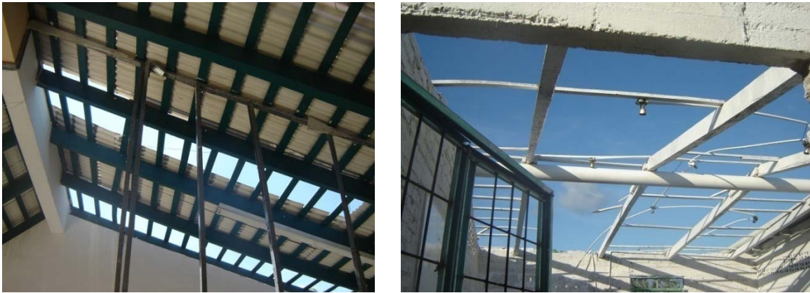
Figura 2.10 Desprendimiento de las cubiertas (parcial y total)
