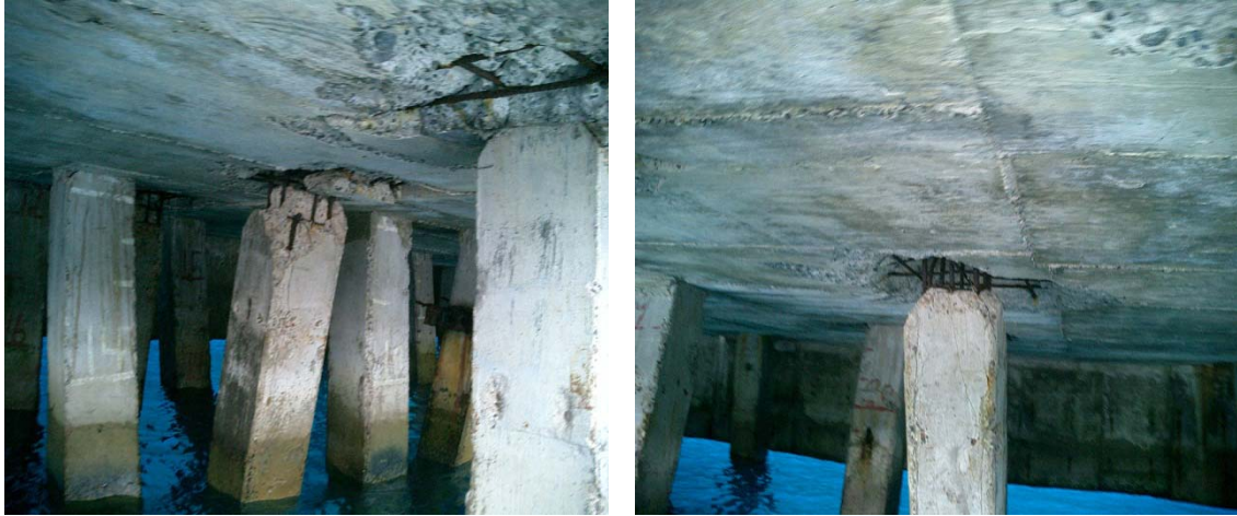
Figura 2.20 Estado de algunos pilares al final del muelle
