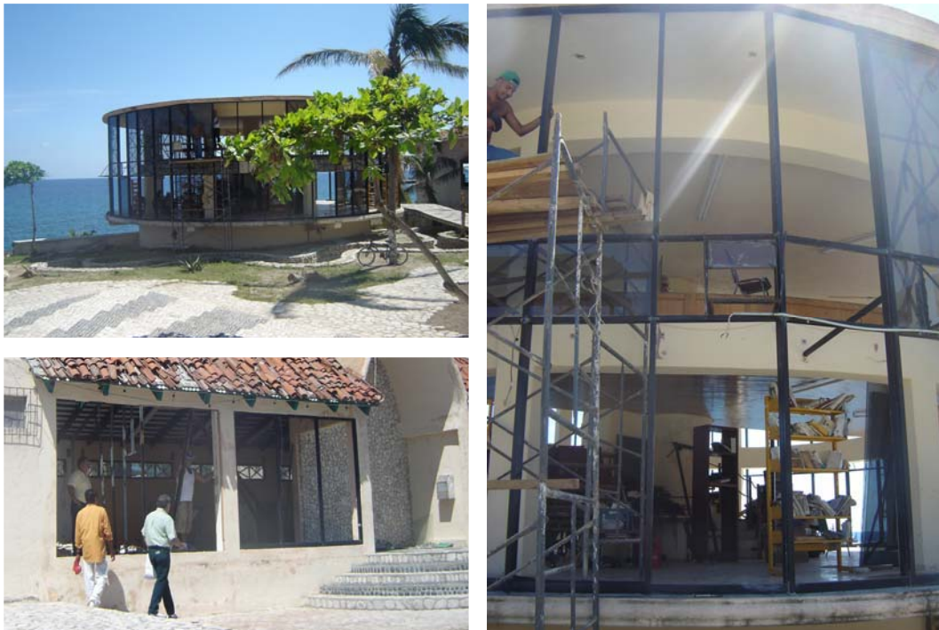
Figura 2.11 Ejemplos de cristalería y cancelería afectadas
