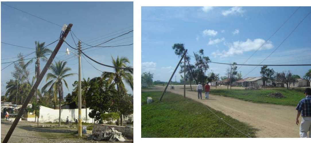
Figura 2.15 Líneas de energía y de teléfono afectadas
