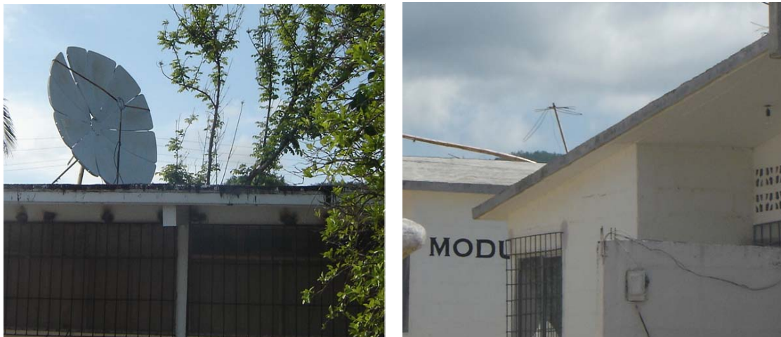
Figura 2.13 Antenas y paneles solares afectados
