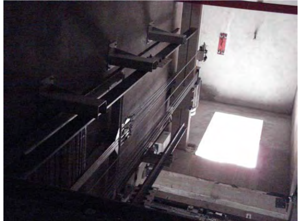
CUBO DE ELEVADOR, CABLES Y CONTRAPESOS.
