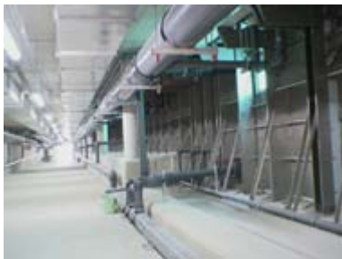
Placas de acero inoxidable tipo S30403, típicamente de 90 centímetros de ancho y 2 milímetros de espesor, forman las paredes de la alberca.
