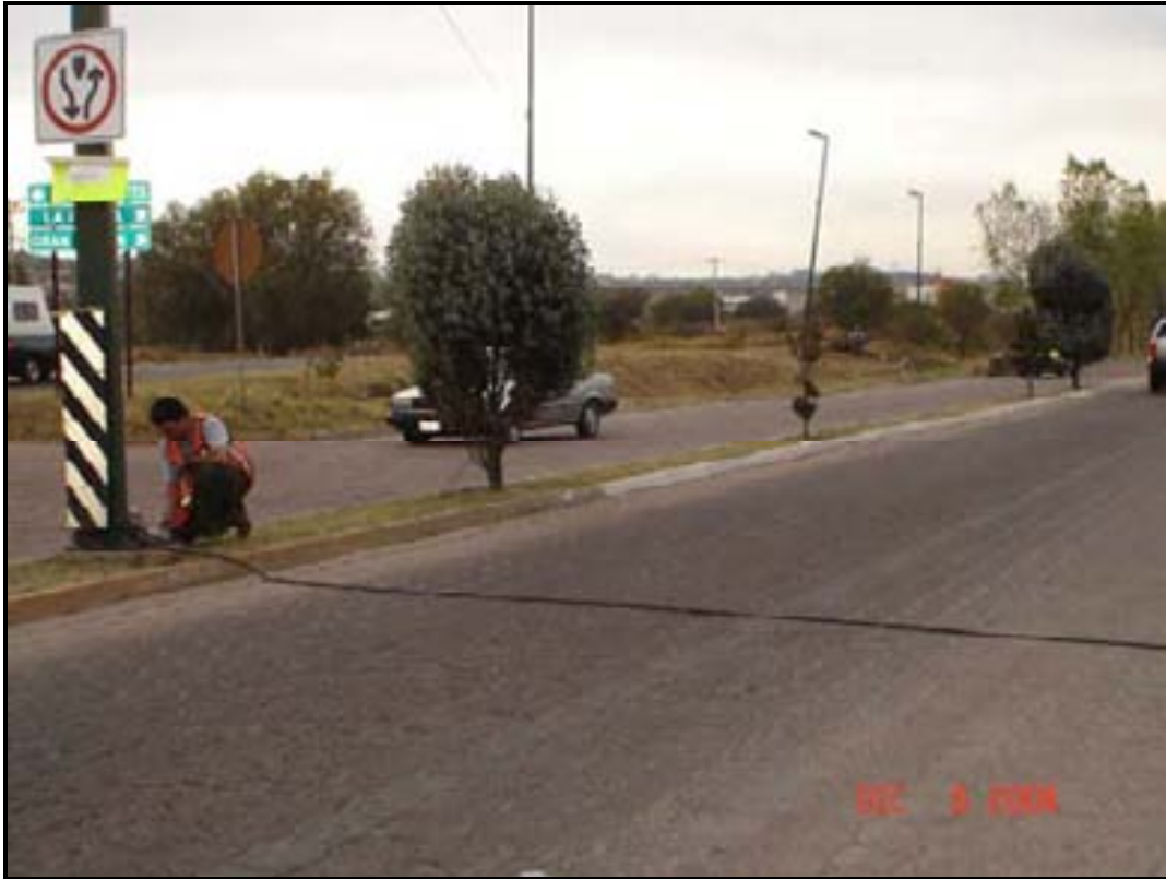
Figura 3.7.5. Revisión de equipo de aforo automático
