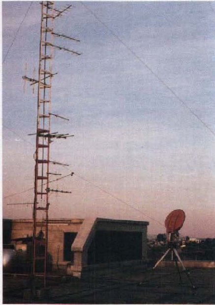
Figura 44. Torre con las antenas de recepción de las señales de telemetría en la azotea del Cenapred. También se observa la antena de microondas que recibe la señal visual del volcán.
