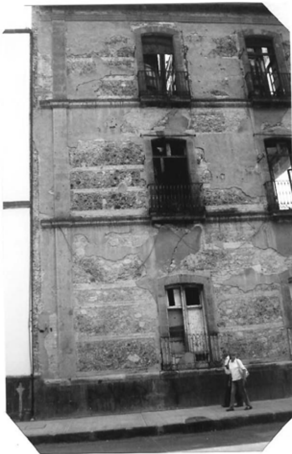
Vista parcial de la fachada principal en el costado sur. Se puede ver a través de las ventanas que los sistemas de techo no existen.
