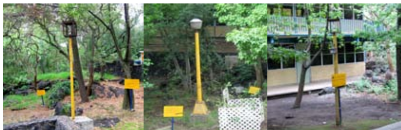
Grupo im. 5 En la iluminación interior hay lámparas "slim line", en exteriores se utilizan faros en postes, son encendidos solamente por las tardes y noches.
