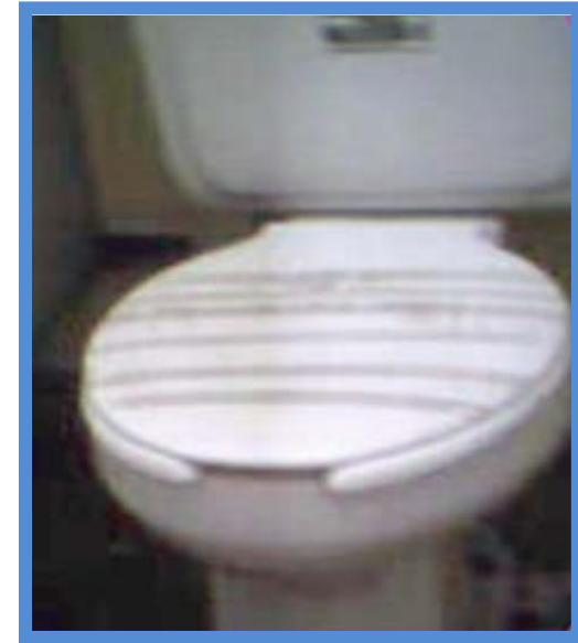
Fotografía 10. Tapa de inodoro en malas condiciones pegado con cinta adhesiva.
