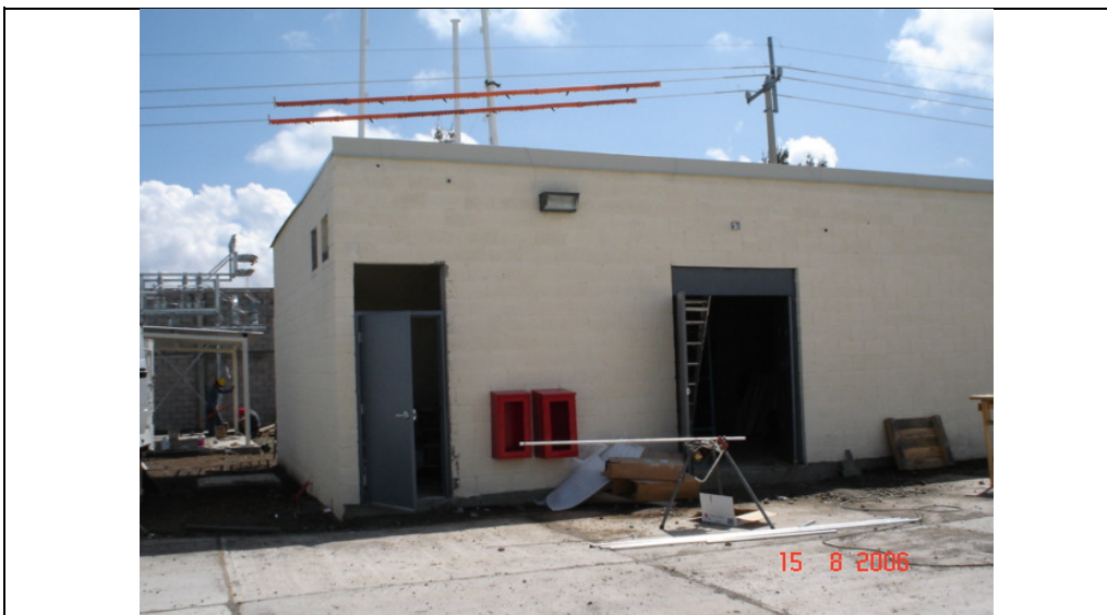
FOTO No.8.- Caseta de control con equipamiento contra incendio (puerta, extintores, alarmas y sensores).
