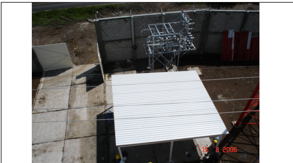
FOTO No.4.- Estacionamiento concluido y colocado en su posición final, al fondo banco de capacitores montado y canalizado.
