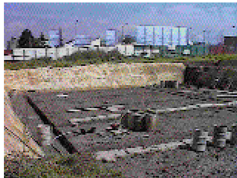
figura 3.3.5 Excavación sin apuntalar (ref 15)
