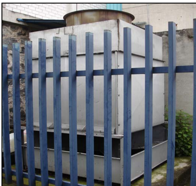
Figura 4.5 Torre de enfriamiento.
