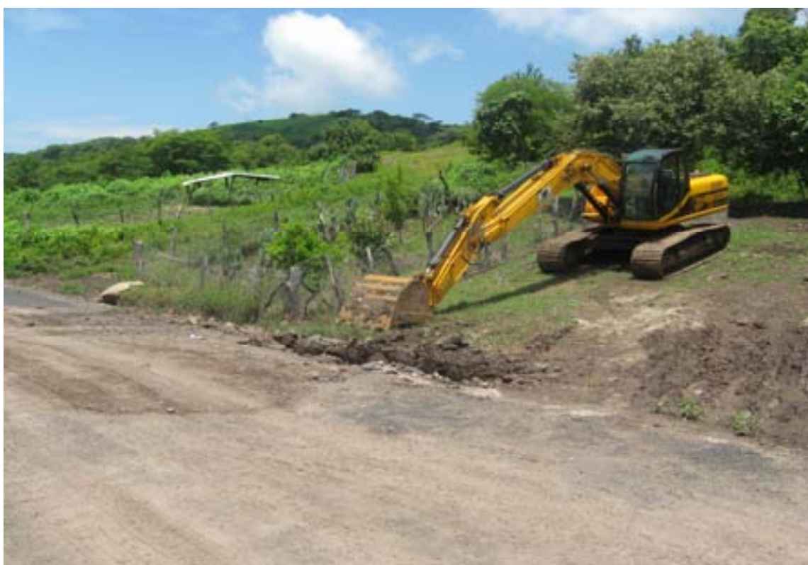
Fig. 5.5. Trabajos presupuestados pero realizados después de terminada la obra.
