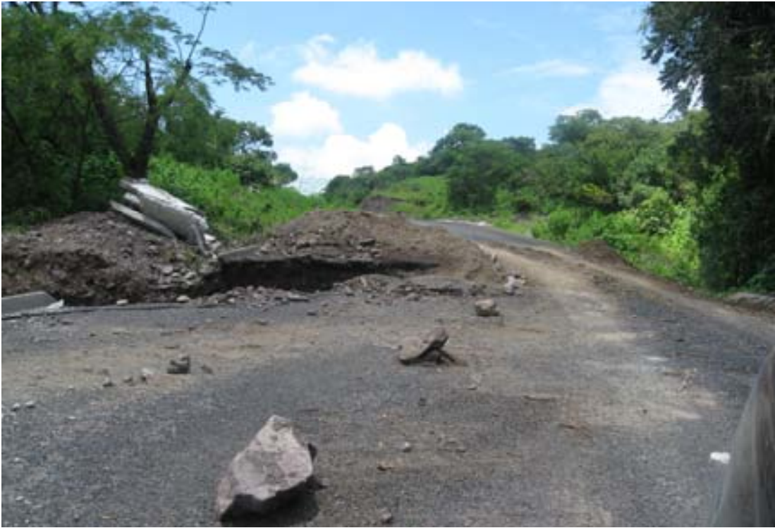
Fig. 5.8. Deslizamientos de la carpeta asfáltica.
