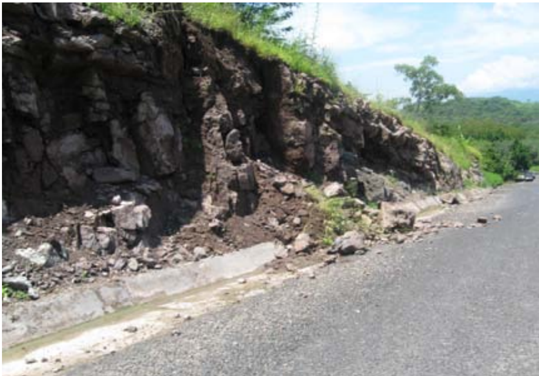
Fig. 5.7. Derrumbe en taludes.
