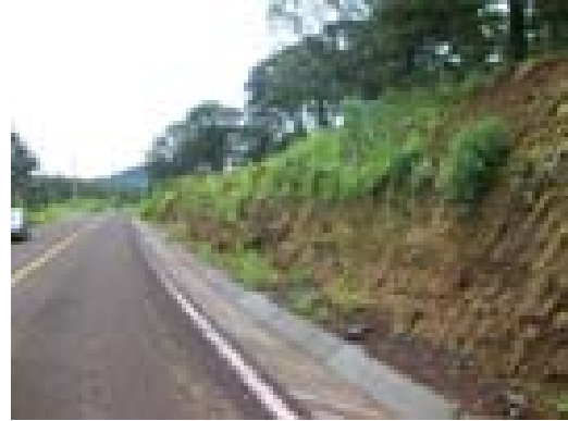
Imagen 13, Se muestra en la fotografía, la cuneta que va a lo largo del corte del terreno, protegiendo el cuerpo del camino. Fuente: propia
