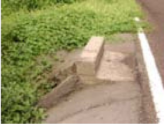
Imagen 4, Localización de la alcantarilla de losa, con la vegetación que la rodea. Km. 7+180 Fuente: propia
