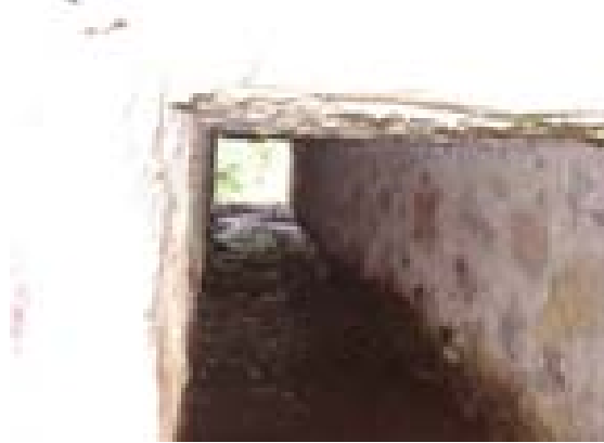
Imagen 5, En la alcantarilla que se muestra, se observa el asolve y así como sus dimensiones Km. 7+180 Fuente: propia
