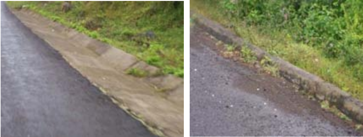
Imagen 3.15. Estado actual en que se encuentran las cunetas y guarnición.
