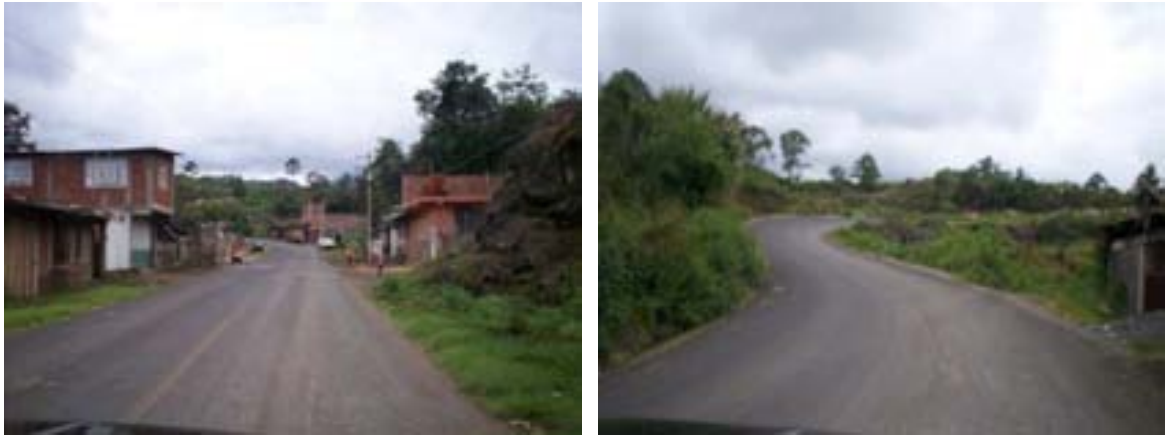
Imagen 3.12. Condiciones actuales de la carpeta asfáltica.
