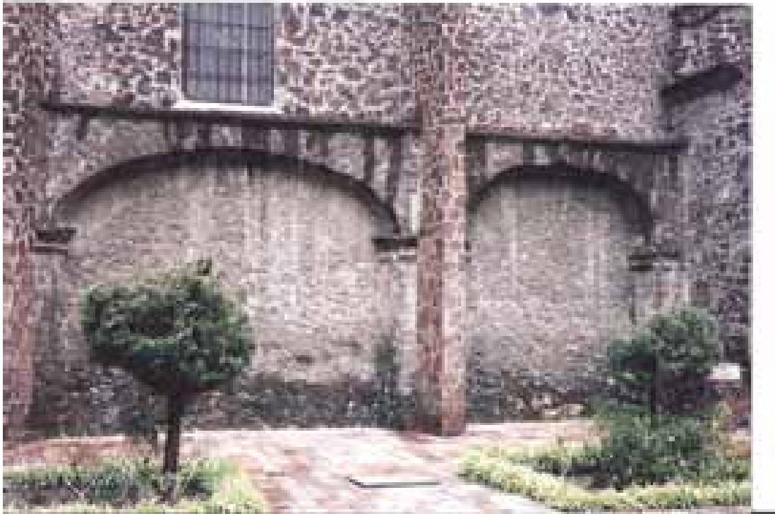
FIG. 58. La Concepción Tlaxcoaque. Vanos tapiados en los muros laterales. RGT (2006).
