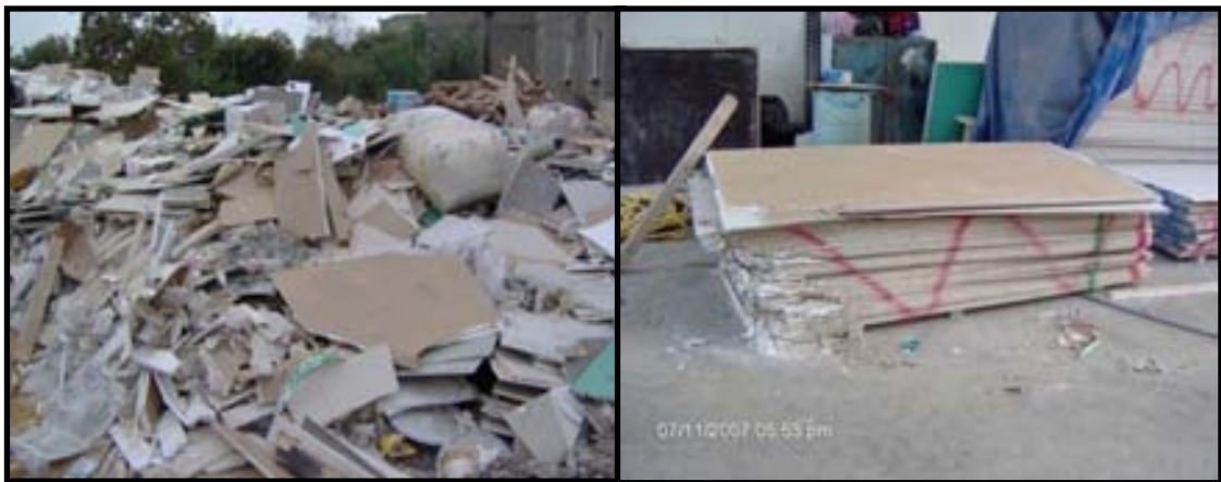
Figura 3.14: Residuos de tabla roca.
