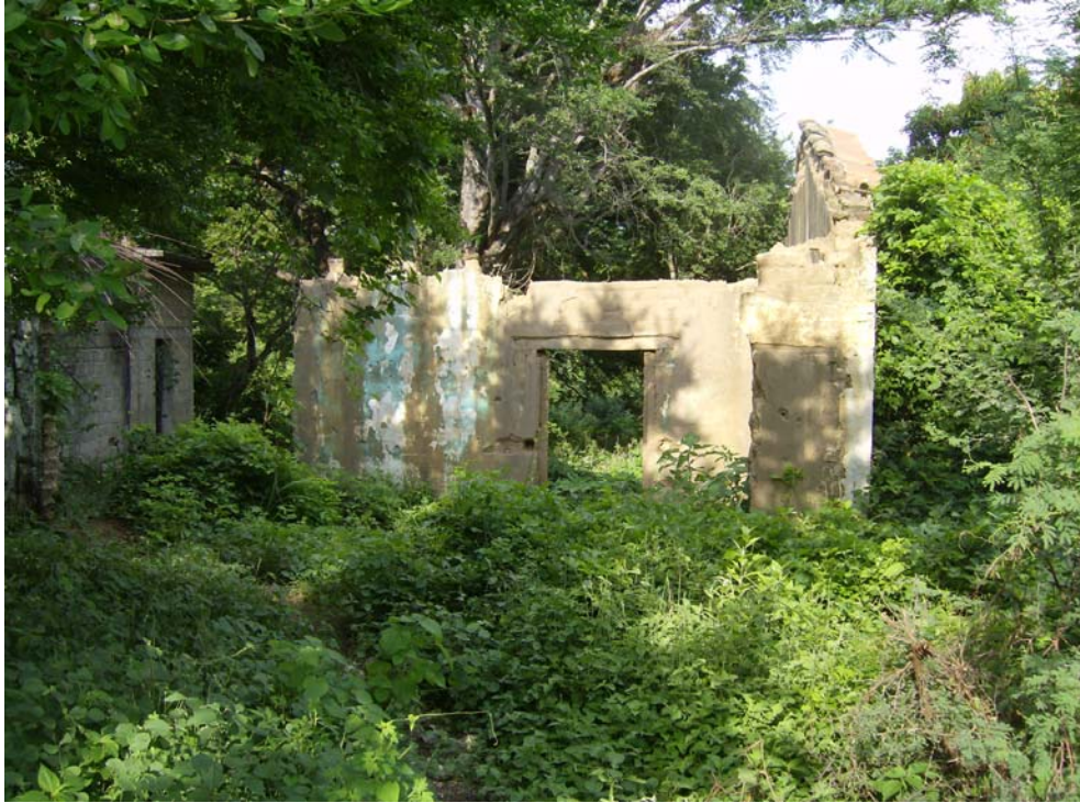
Viviendas afectadas a causa de inundaciones ocasionadas por el desbordamiento del río Lagartero
