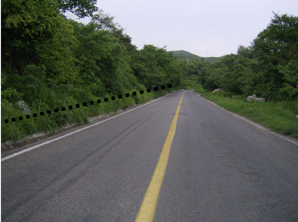
Zonas que se afectan por el desbordamiento de río Lagartero Carretera federal N. 195, línea punteada negra indica el nivel al que puede llegar el agua en caso de desbordamiento.
