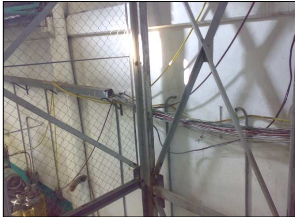
Figura 2.4. Cables expuestos cerca del elevador de carga.
