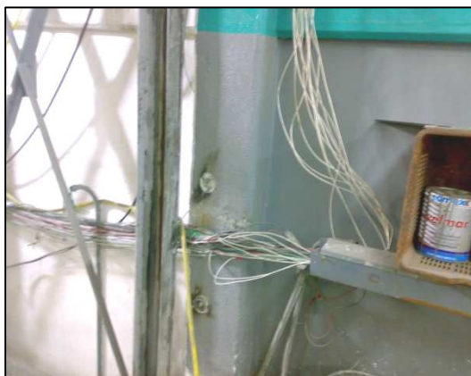
Figura 2.6. Cables expuestos y cerca de materiales inflamables.
