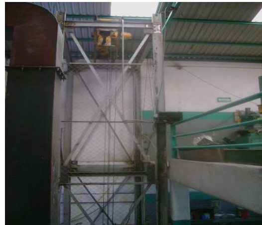
Figura 2.40. Elevador de carga. Plataforma de carga.
