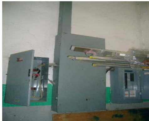
Figura 2.41. Esta imagen muestra el centro de carga principal con que se alimenta la fábrica y que sirve para alimentar a las máquinas de la nave.
