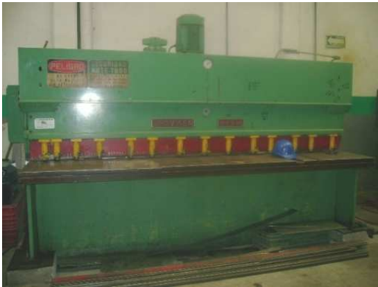
Figura 2.29. Cortadora de lámina con alimentación del centro de carga principal.
