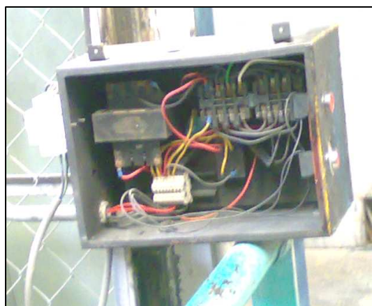
Figura 2.7 B. Cables expuestos.
