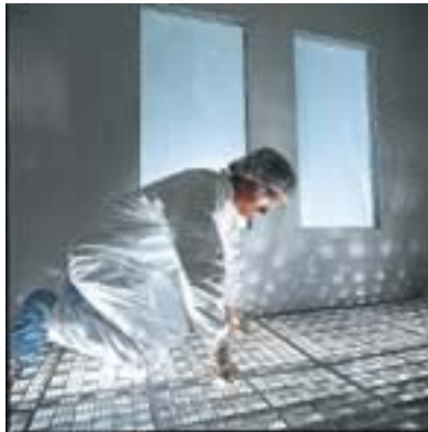
Figura 2.21 Paneles perforados colocados en un cuarto limpio con cámara plena
