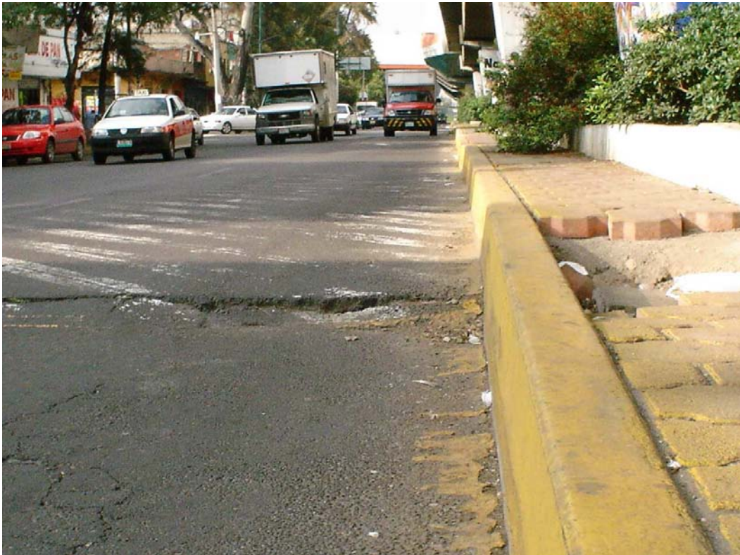
Gráfica VI.3.2 Deformación de la carpeta asfáltica
