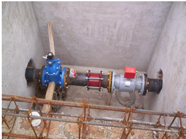
Instalación de piezas especiales de 6" de diámetro, para Sitio de Medición en Av. 699 y Calle 606.
