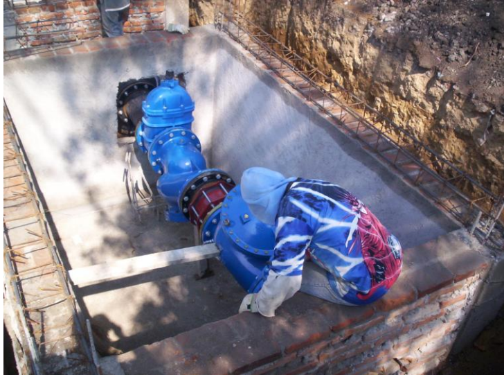
Instalación de piezas especiales de 12" de diámetro, para Sitio de Control en Av. Texcoco y Calle Oriente 11.
