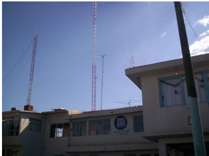
Base y torre instalada sobre azotea, para repetición de señal.
