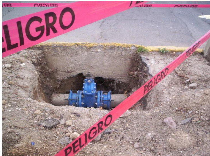
Válvula de Seccionamiento ubicado en Av. 699 y Av. 606 . Sector GAM-38
