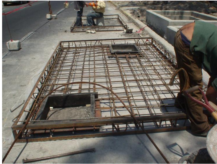
Preparativos para colar Losa-Tapa de Caja de Control en Av. Texcoco y Calle Oriente 11. Sector GAM-40
