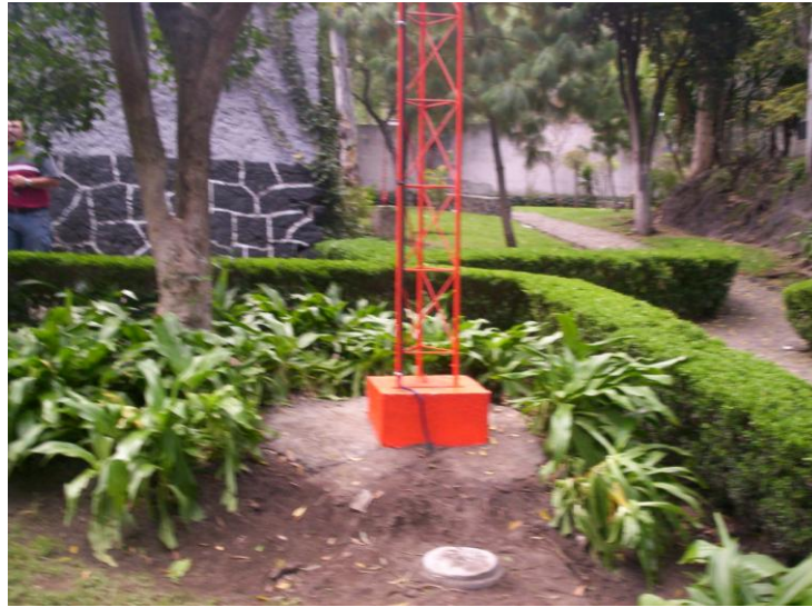
Base de Torre para transmitir señal y electrodo.
