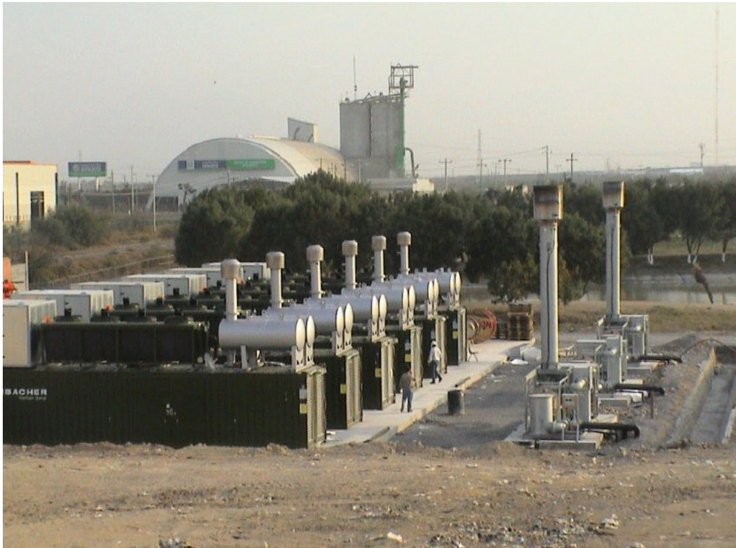
Figura 2.6 Central de biogás- SIMEPRODESO (Seisa, 2005)
