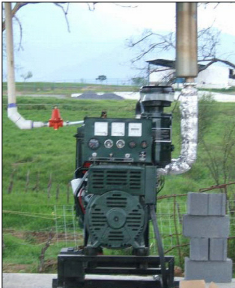
Figura 4.4 Motogenerador marca Perkins (Ochoa, R. y Ortega, C. 2007)
