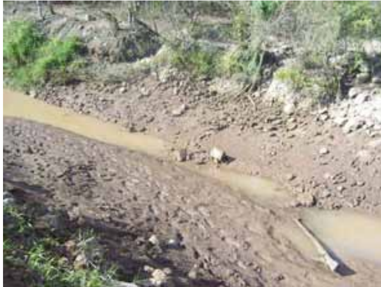
Foto 4.10 Material expansivo del fondo de la caja del canal.
