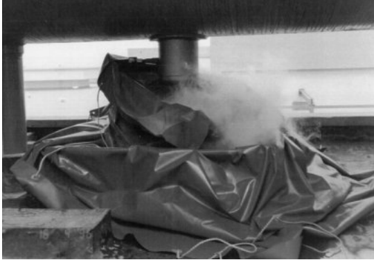
Fuga de amoníaco en una pipa
