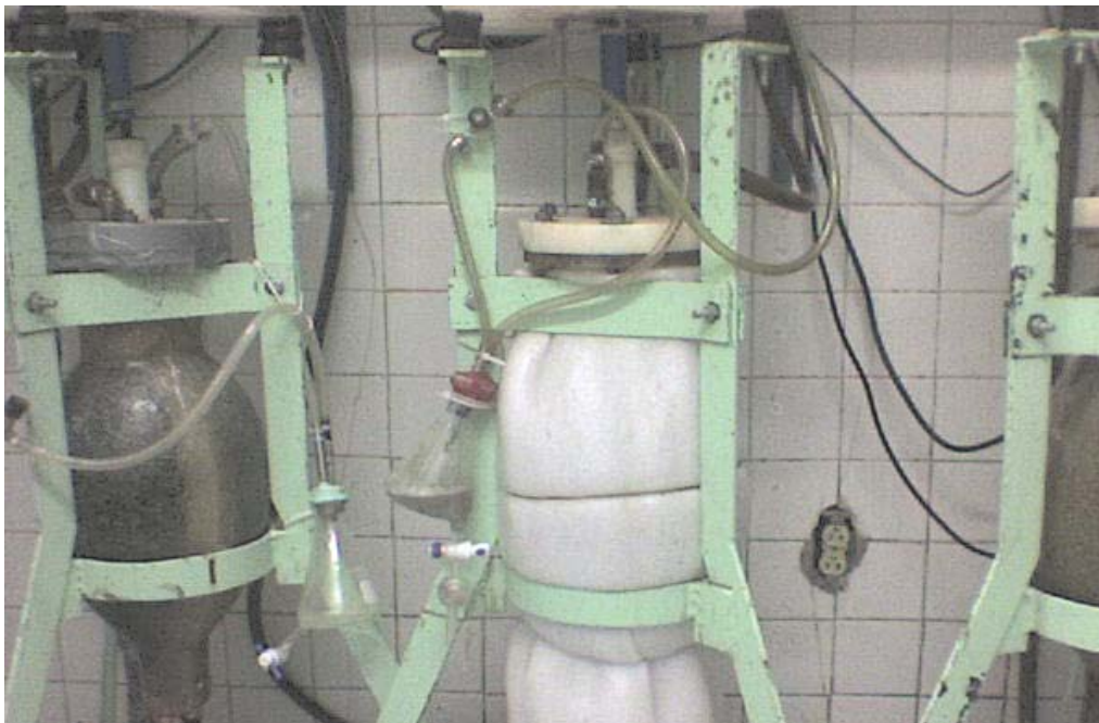
Figura 4.2 Al centro, uno de los dos digestores termofílicos utilizados en este trabajo
