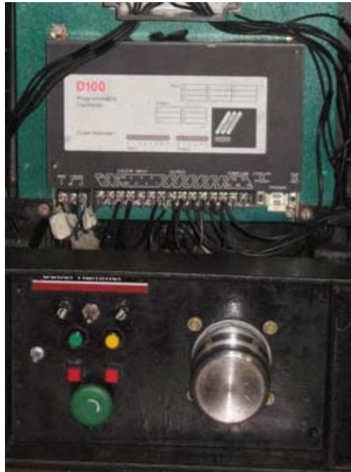
Figura 150 Modo de operación de control de entrada digital con potencial de arranque nulo y operación automática a través del PLC.
