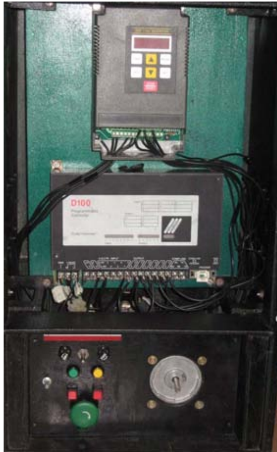
Figura 149 Modo de operación de control de entrada digital y operación automática a través del PLC.
