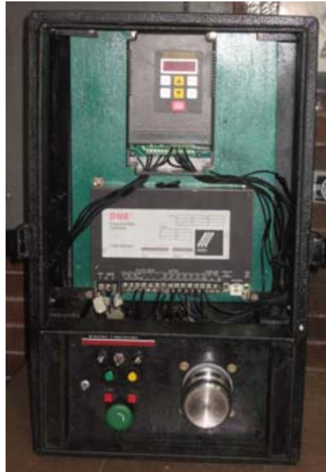
Figura 151 Modo de operación de control de entrada digital con potencial de arranque distinto de cero y operación automática a través del PLC.
