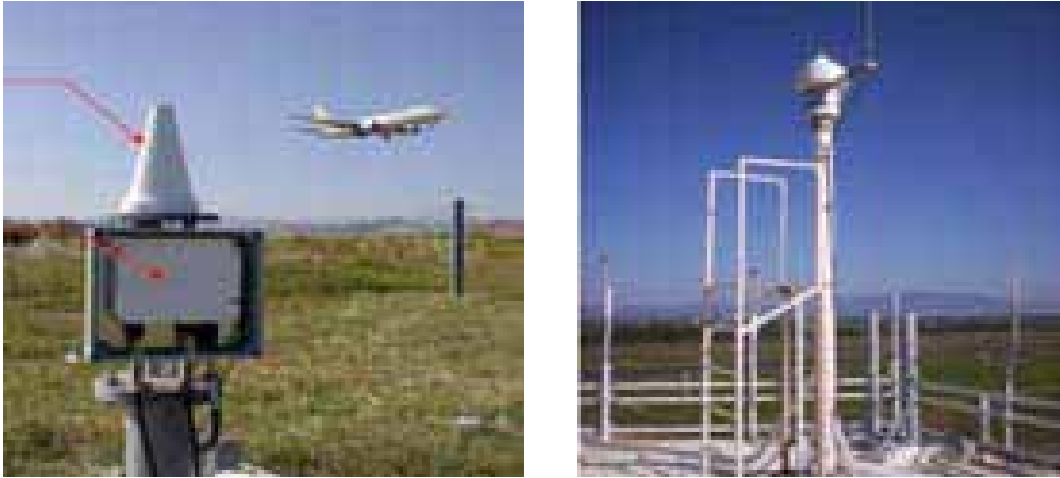
Figura 4.19. a) y b) infraestructura de comunicaciones mediante antenas GPS-LAAS
