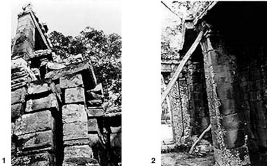
1. vista de la biblioteca norte del Templo Bayon 2. columna apuntalada debido al precario estado de conservación
