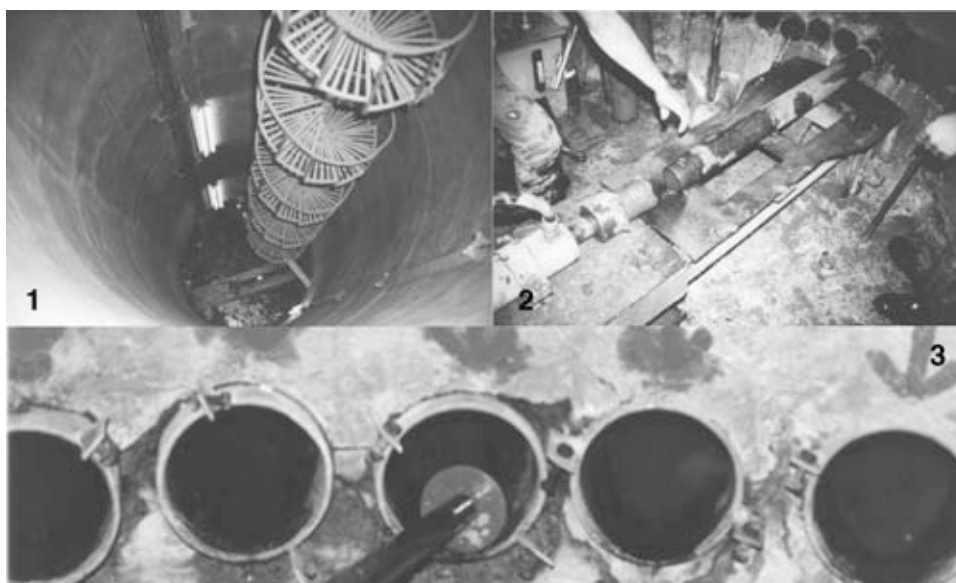
1. lunbrera de acceso a la los suelos blandos 2. tubos sub-excavadores hincados a presión con cilindro hidráulico 3. detalle de las ventanas por las que penetran los tubos
