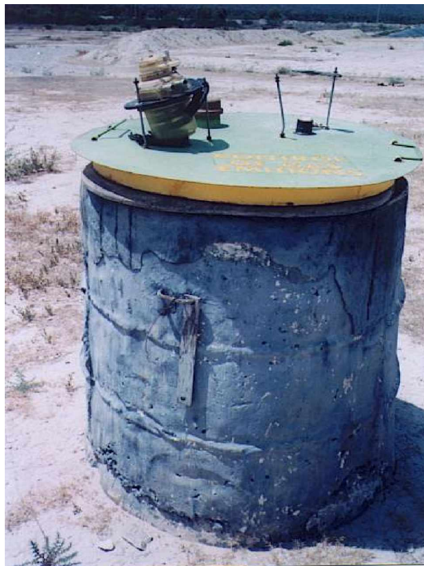
Fotografía 20. Estado de uno de los tambos para control de emisión de gases en una de las celdas de confinamiento
