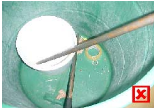
Fig. 7.- Aunque haya equipo dentro de la planta que momentáneamente esté fuera de servicio o recipientes que se encuentren libres, el equipo y materiales deben utilizarse únicamente para su función. No se debe dejar materia ajena al proceso como cinta o cubetas dentro de los tambores.
