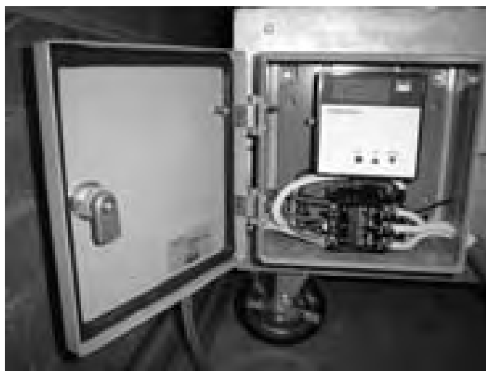
Figura 4.19. Detalle del controlador digital de temperatura del termotanque
