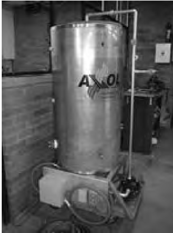
Figura 4.18. Termotanque con control e instrumentación
