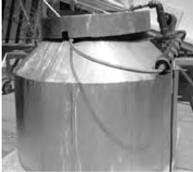
Figura 4.20. Tanque de almacenamiento de agua caliente
