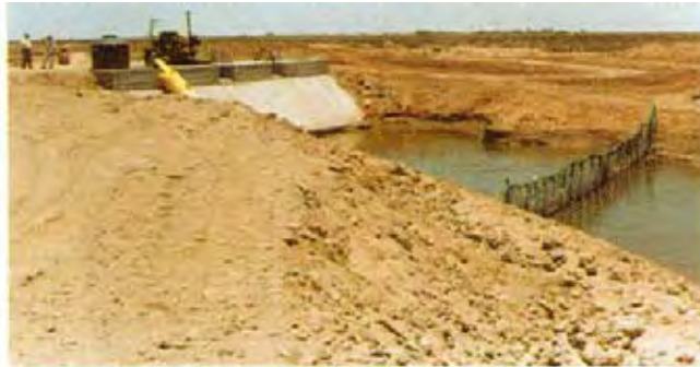
Foto 2.1. En esta fotografía se puede observar el tipo de malla sostenida por tres palos y el deterioro de la misma en el canal de llamada de una de las granjas en el estado de Sinaloa.
