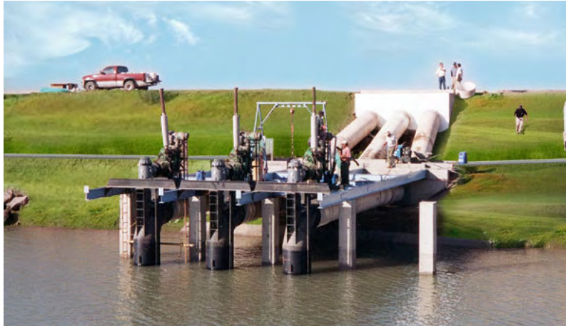
Foto 3.2. Estructura de soporte para las bombas.
