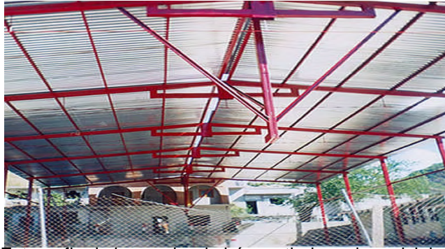
Fotografía de la cancha de básquetbol en el municipio, en obra negra.
