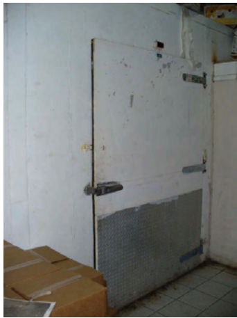
Cuarto frío puerta
