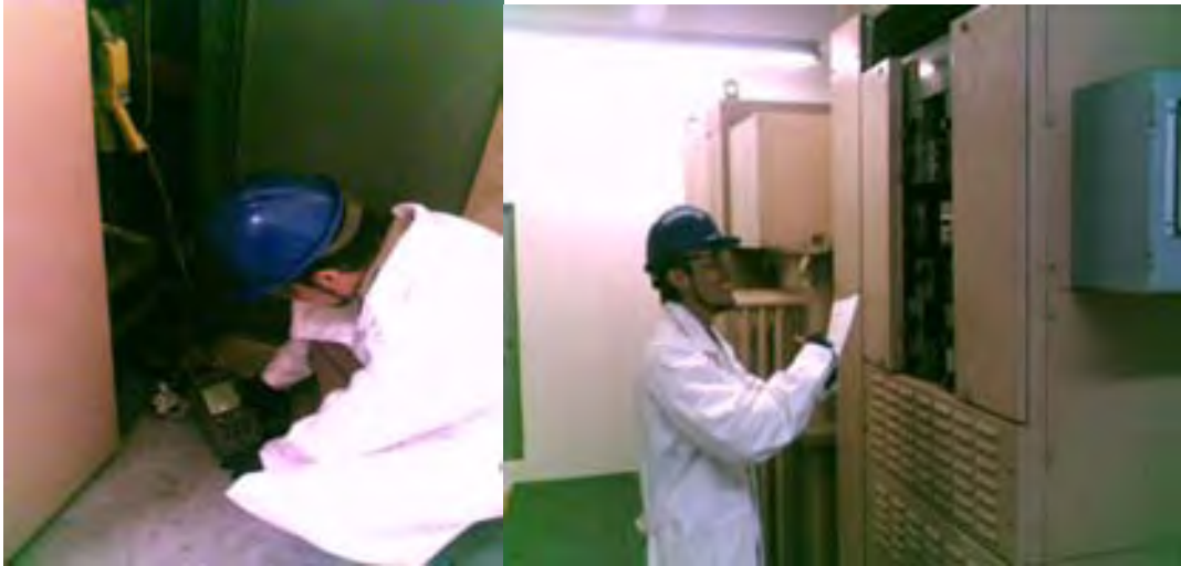
Figura 2.14 Instalación de equipo de medición.
