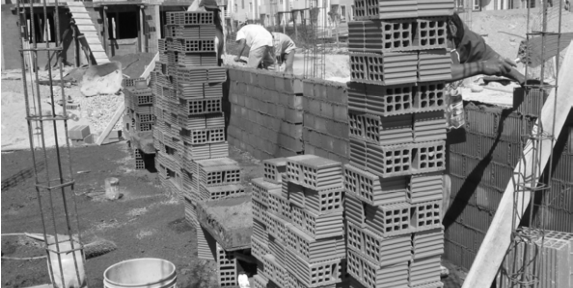
Fotografía 2. Muros de planta baja de tabique de barro comprimido juntado con mortero-arena.
